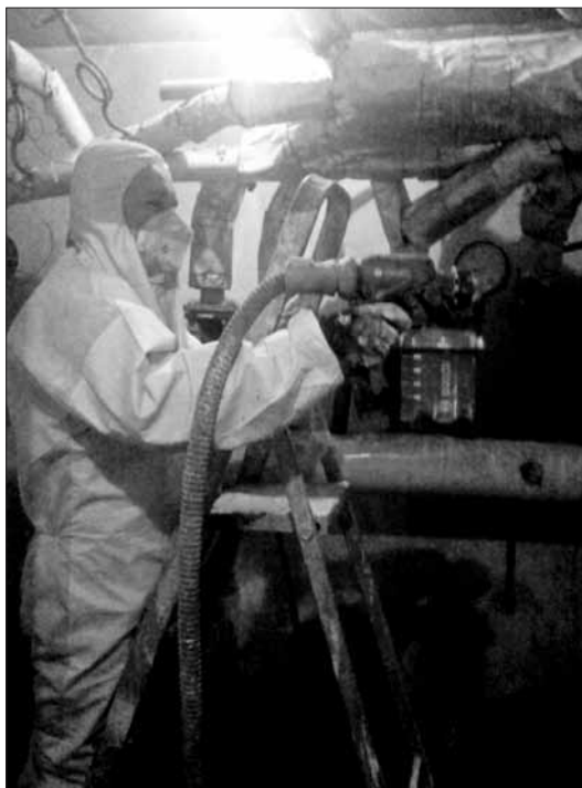
Osiedle „Węzłowiec”. Przy Władysława Jagiełły 25-41 rozpoczęto prace odnawiania pomieszczeń rozdzielaczy centralnego ogrzewania
