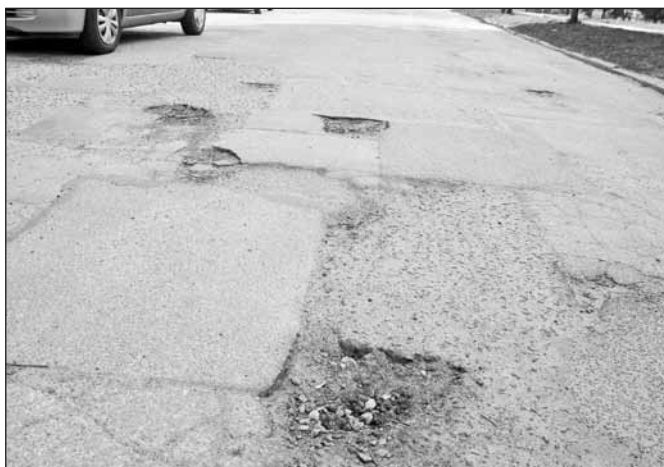
W złym stanie jest droga miejska - dojazdowa do budynków Władysława Sikorskiego 2 i 4
