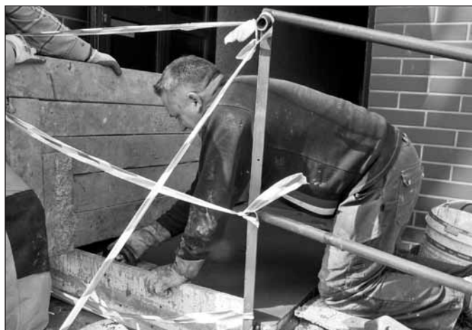
Schody i zjazd dla wózków kwalifikował się już do remontu – ZHP 11
