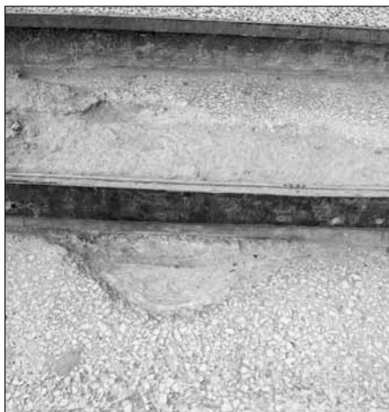
Schodów „do poprawy” też jest trochę – Walerego Wróblewskiego 69
