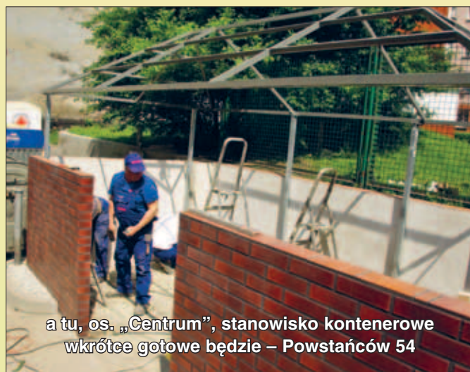
os. „Michałkowice”. Kolejne zabudowane stanowisko kontenerowe jest – Poczta 10...
