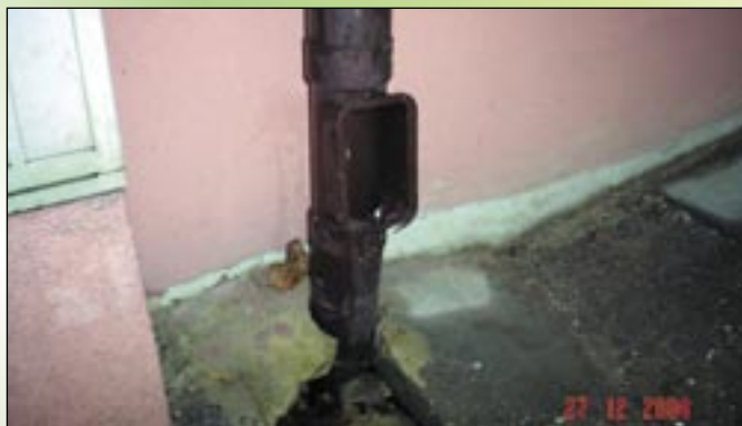
Wyparowało denko na rewizji rury spustowej – Grunwaldzka 16C.
