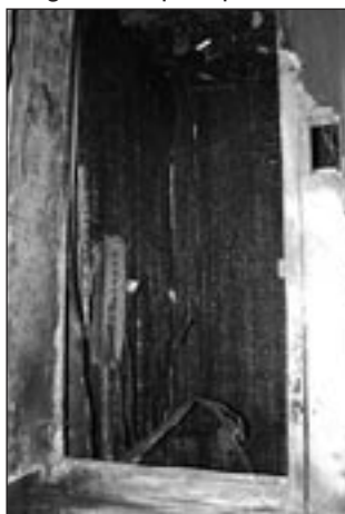
Najkosztowniejsza ubiegłoroczna dewastacja – spalona doszczętnie winda w budynku przy ul. H. Wróbla 6D.
