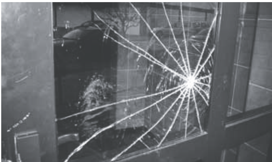
Zniszczone drzwi wejściowe – Wojciecha Korfanteo 3A.
