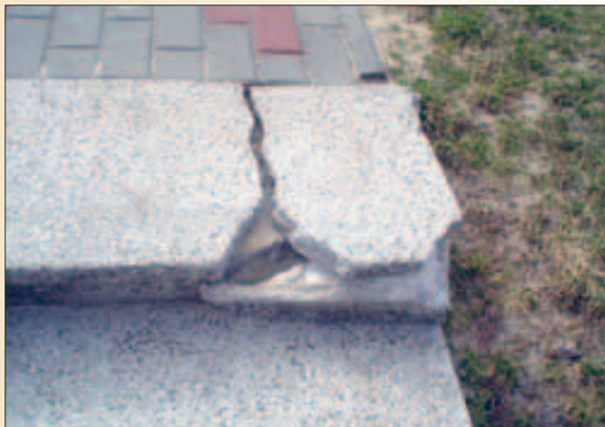
Os. „Tuwima” – tak zniszczone zostały schody w stronę budynku ul. Okrężna 2.
