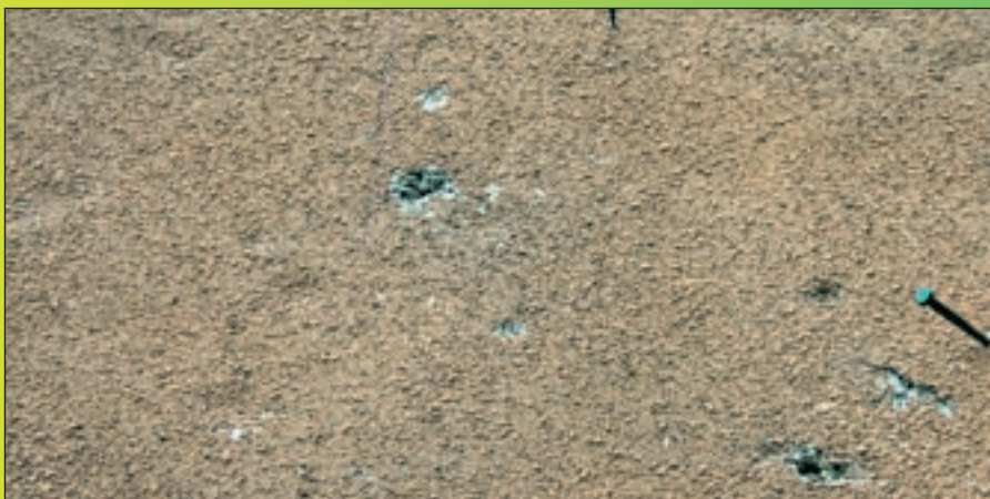
Ubytki są widoczne. Reszta należy do przyrody.
