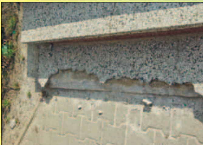
Uszkodzone schody terenowe przy ZHP 9.
