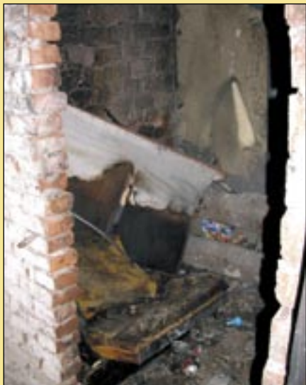
Palilo się przy ul. Przyjaźni 22a – na zdjęciu – i przy ul. H. Wróbla 6d.
