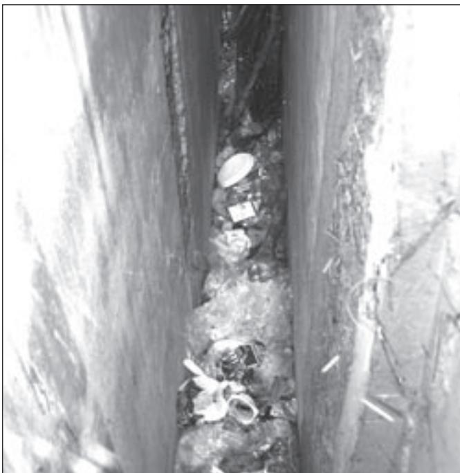
Szczelina dylatacyjna i jej zawartość. Budynek przy ul. M. Skłodowskiej-Curie 77 – osiedle „Bańgów”
