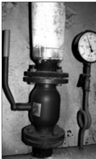
Potężne zawory, to też element instalacji c.o. w budynku.
